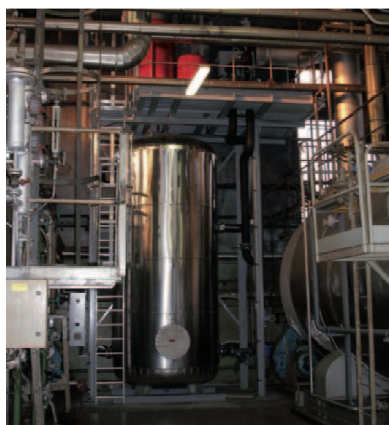
Récupérateur de chaleur installé sur la chaudière
